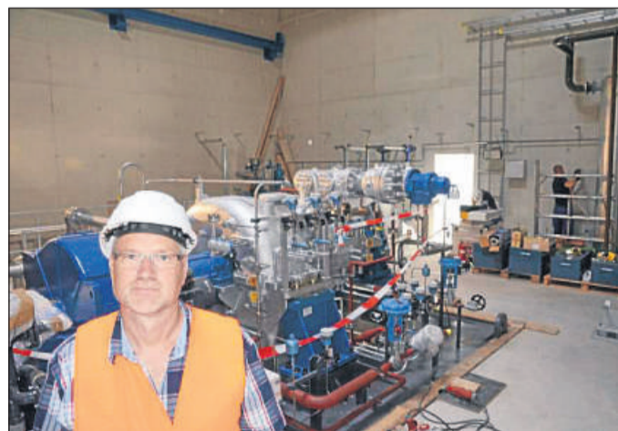
Leistungsfähig: Kraftwerksleiter Herbert Ruhwedel vor der Turbine, die den Strom erzeugt.
