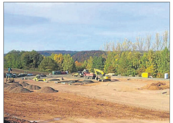
Baubeginn: Die Grundfläche der Anlage beträgt zwei Hektar. Jetzt steht dort das Kraftwerk.
