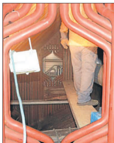
20 Meter hoch: Blick in den Kessel des Kraftwerks.
