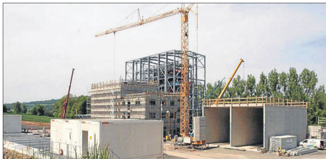
Bauphase: Das Kraftwerk ist im Bau. Gut zu sehen ist der Zugboden rechts im Bild. Dort können 400 Tonnen Holz gelagert werden, um Radladerverkehr am Wochenende zu vermeiden. 2 Fotos: privat
