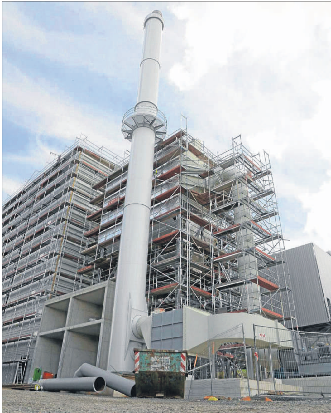
Gewaltig: Das Holz hackschnitzelkraftwerk der Firma Prolignis soll im November ans Netz gehen. Es hat eine elektrische Leistung von 5 MW/h und eine thermische Leistung von zehn MW/h. Das Gebäude ist 26 Meter hoch. Fotos: Dewert
