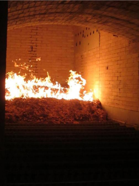
Abbildung 7: Erstes Feuer (Quelle: Th. Arens Anlagenbau GmbH)
